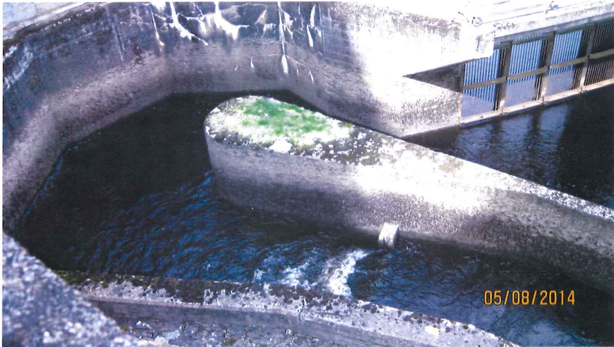
Kuva 4. Pitlochryn voimalaitoksen kalatien suuaukko ja ohjainaita.
