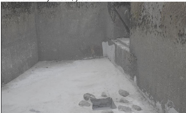
Kalatien ylimmän tasausaltaan pohjan korjaus betonointi ja syy pohjan kohtuuttomalle kulumiselle.
